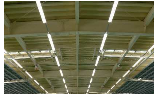
支店のLED照明
