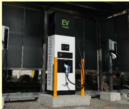
電気小型トラック充電設備
