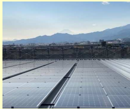
太陽光パネル
