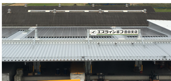
エスラインギフ豊田支店の屋根に設置した太陽光パネル
